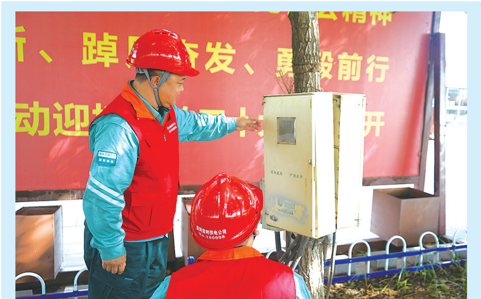
8月26日,国网梨树县供电公司党员服务队深入梨树县国家百万亩绿色食品原料(玉米)标准化生产基地检查用电设备,确保供电安全。
