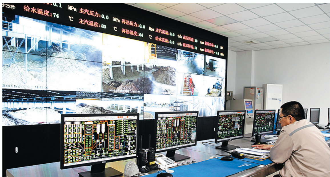
工作人员在主控制室内，监控项目运行情况。
